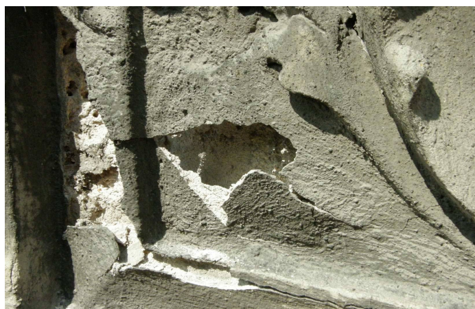
Fot. 2. Odspojenia tynku
